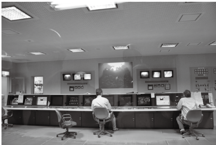
生活垃圾焚烧控制室（姜晨 / 提供）
