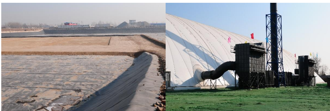
污染土暂存场防渗（左）和修复产生的废气处理（右）
